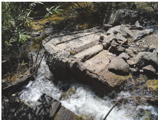
Рис. 3. Разрыв плотины № 2 (вид вниз по течению)
